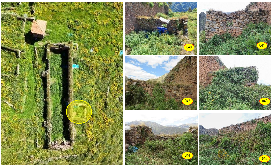
Figs. 040 y 041: Vista de la sacristía, se aprecia colapsos de la parte superior del muro norte, cabecera, paramento interior y exterior del muro con presencia de musgos, superficie del suelo totalmente cubiertos por vegetación, además el colapso del muro con parte del dintel de la ventana ha generado gran inestabilizado y riesgos de pérdidas, madera del dintel incompleta y en mal estado. Figs. 042 y 043: Colapsos de la parte superior del muro sur, cabecera, paramento interior y exterior con presencia de musgos y cubiertos por vegetación. Figs. 044 y 045: Colapsos de la parte superior del muro este han generado inestabilidad estructural en este sector, cabecera, paramento interior y exterior del muro con presencia de musgos y cubiertos por vegetación.
