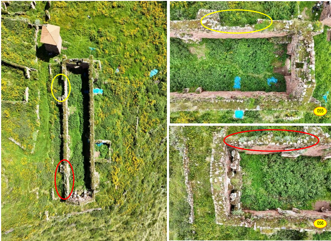
Figs. 055 y 056: Vista aérea con los detalles de la patología estructural, apreciamos los puntos críticos ubicados en el sector norte y sur del muro de la epístola, los colapsos que han comprometido más del 50% de las secciones del muro en estos sectores. Foto Rodrigo López.
