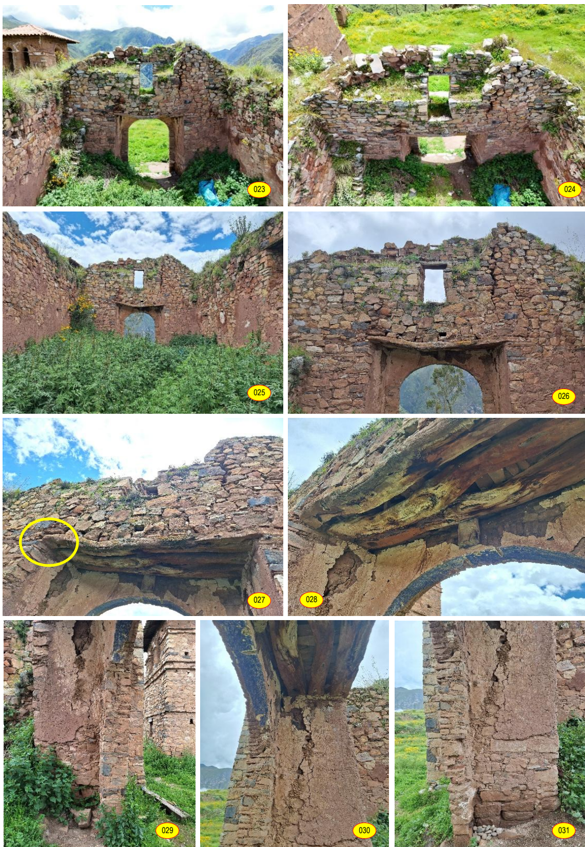
Figs. 023 y 024: Vista aérea interior del muro hastial de la portada de pies, se aprecia el colapso total de la parte superior de la sección triangular del muro y colapsos parciales, inestabilidad estructural generalizada de todo este sector con serios riesgos de colapso. Fotos Rodrigo López, Figs. 025 y 026: Vistas del interior del muro hastial de la portada de pies, apreciamos la deflexión del dintel del vano de acceso abocinado, además grietas en la parte intermedia superior izquierdo del hastial, , Fig. 027: Vista interior muro portada, detalle de la deflexión del dintel del vano de acceso abocinado, grietas en la parte intermedia superior izquierdo del hastial, detalle del poco traslape o apoyo del dintel en el muro Fig. 028: Detalle del interior de los tres maderos visibles del dintel del vano de acceso abocinado. Figs. 029, 030 y 031: Vistas de las jambas del acceso, en la base de la estructura se aprecia alta concentración de humedad y vegetación, los enlucidos sin color y pintados de blanco y azul presentan fisuras e inestabilidad.
