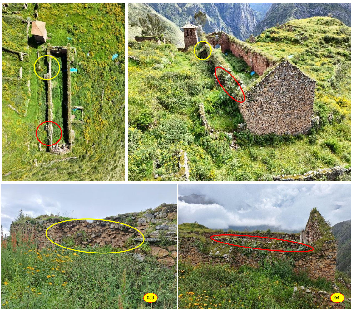
Fig. 053: Detalles de la patología estructural, puntos críticos ubicados en el sector norte del muro de la epístola, se aprecia colapsos que han comprometido más del 50% de la sección del muro en este sector, además superficies a nivel de pisos y cabeceras cubiertas totalmente por vegetación. Fig. 054: Detalles de la patología estructural, puntos críticos ubicados en el sector sur del muro de la epístola, entre los contrafuertes 5 y 6 y el vértice con el muro testero, se aprecia colapsos en la parte superior del muro han comprometido la estabilidad de todo este sector, además superficies a nivel de pisos y cabeceras cubiertas totalmente por vegetación.
