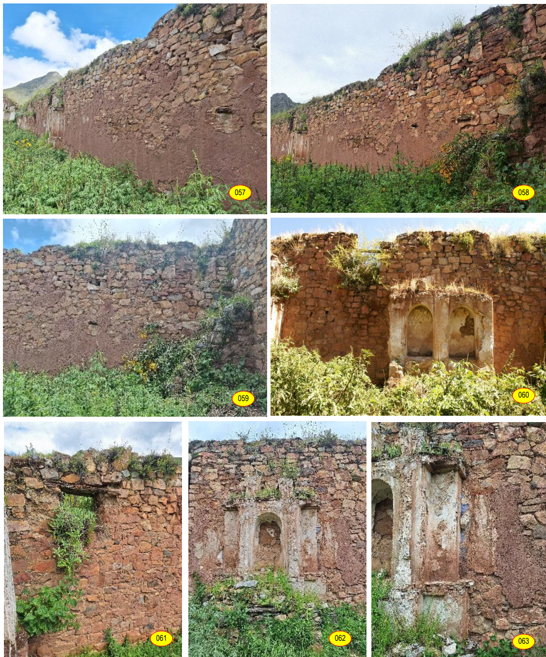
Figs. 057 y 059: Paramento interior del muro de la epístola, se aprecia gran pérdida de los enlucidos sin color y pintados de blanco por erosión eólica y pluvial, superficie del suelo y cabecera de muro totalmente cubierta por vegetación. Figs. 060 y 061: : Detalle del muro de la epístola, paramento interior, ventanas ubicadas cerca a uno de los altares laterales, se aprecia que el colapso de este sector del muro con parte del dintel de la ventana ha generado gran inestabilizado y riesgos de pérdidas, la madera de los dinteles que aún se conservan se encuentra en mal estado, las superficies del suelo y cabecera de muro totalmente cubiertas por vegetación y musgos. Figs.062 y 063: Vistas del paramento interior del muro de la epístola, detalles del altar lateral de adobe y yeso, presenta pérdidas y colapsos, evidencias de color azul, los elementos que se mantienen en pie con serios problemas de estabilidad, las superficies arquitectónicas de la cabecera y piso están cubiertas por vegetación.
