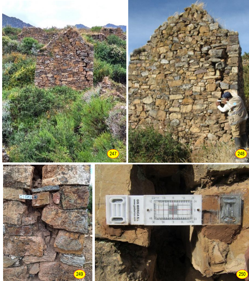
Figs. 247 a 250: Instalación de fisurómetro para el monitoreo estructural.
