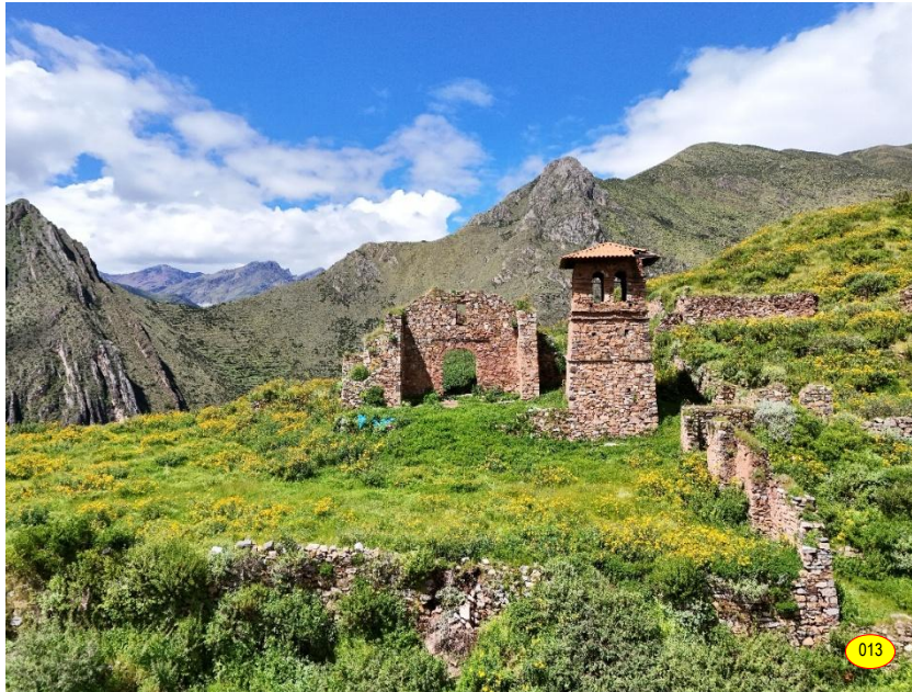
Fig. 013: Vista general de la fachada, portada de pies, atrio y torre exenta, aspecto actual, es notoria la erosión eólica y pluvial que presentan las superficies de los paramentos, nivel de suelo, cubiertas totalmente con vegetación. Foto dron Rodrigo López, marzo 2025.
