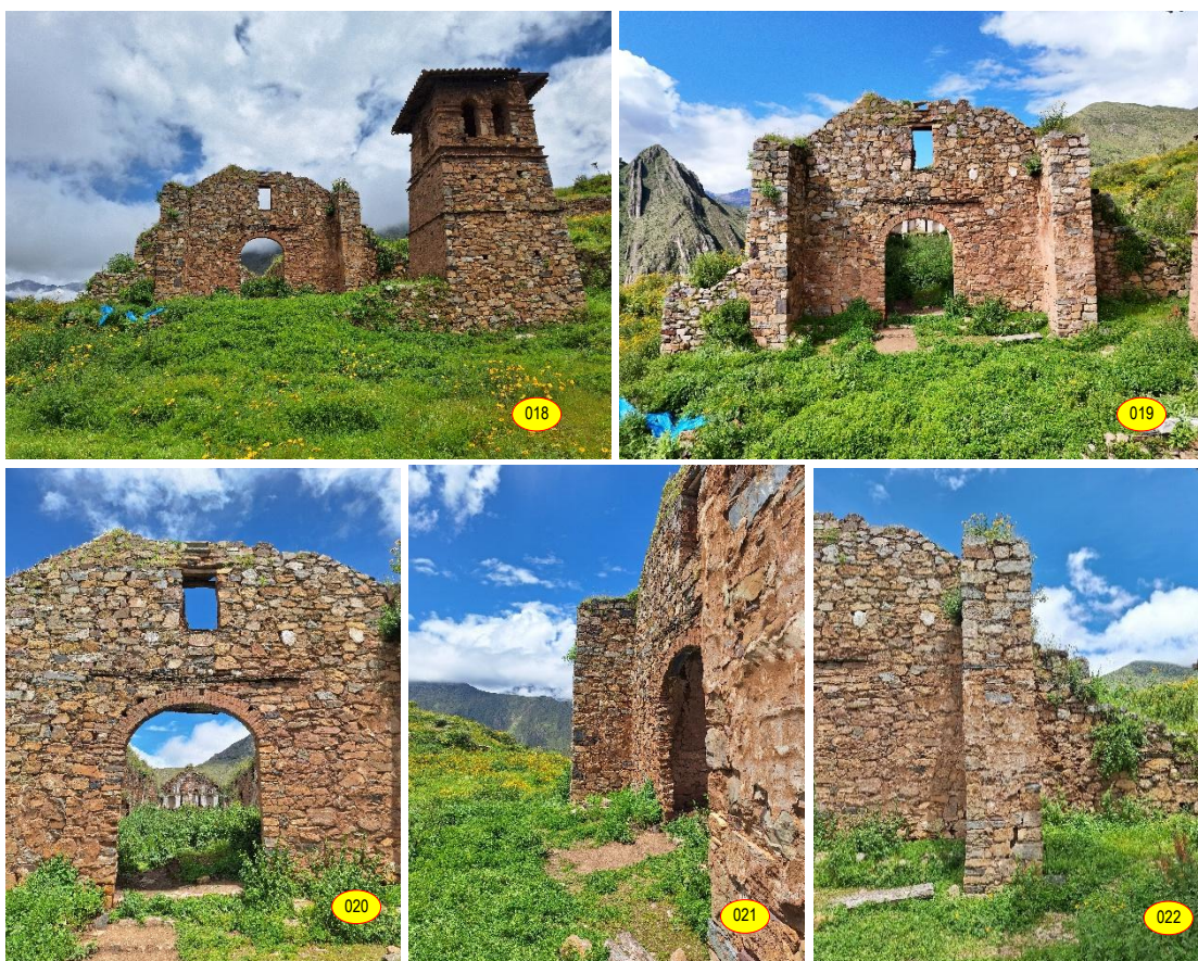
Fig. 018: Vista del atrio, portada de pies y paramento norte de la torre , se aprecia las superficies arquitectónicas con pérdidas casi totales de los enlucidos por erosión pluvial y eólica, a nivel de piso totalmente cubiertas por vegetación. Figs. 019 a 022 : Portada de pies , detalles del paramento externo, colapso de la parte superior, arco de medio punto de ladrillo, presenta intervenciones anteriores, sobre el arco un dintel de descarga en mal estado, superficies arquitectónicas a nivel de piso totalmente cubiertas por vegetación.
