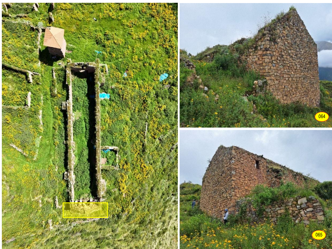
Figs. 064 y 065: Vista en sentido sur norte de los sectores oeste y este del muro testero, su aspecto de aparente estabilidad estructural, se ve afecta en el lado oeste debido al colapso de muro de la epístola en este sector, además la esbeltes de su altura y a la acentuada pendiente que existe entre le lado oeste y este del muro es un riesgo permanente de colapso, se aprecian grietas en los laterales y sección triangular del muro hastial, la superficie del paramento expuesta directamente al viento y lluvia presenta pérdida de morteros por erosión, las superficies arquitectónicas de la cabecera y piso están cubiertas por vegetación.
